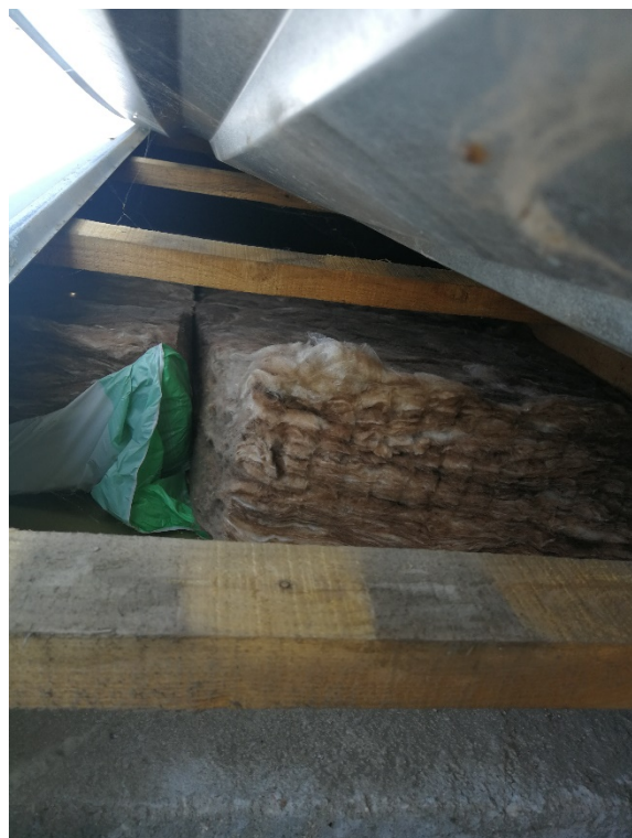
Zdjęcie 3. Wełna na skosach, odkrywka blachy.
