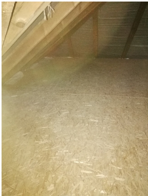
Zdjęcie 3. Płyta OSB na poddaszu.
